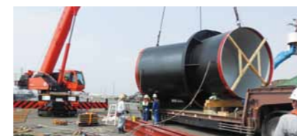
火力発電所 ダクト輸送
